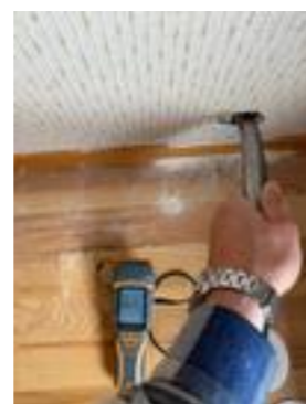
Ingen unormale utslag med pigger i svill ved hulltagning
