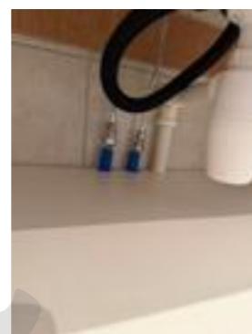
Røropplegg under baderomsinnredning
