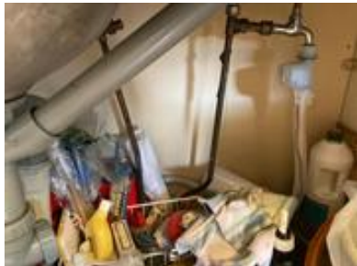
Røropplegg i skap under vask
