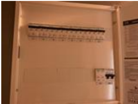
Sikringsskap med automatsikringer.
