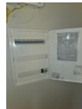
Sikringsskap med automatsikringer og kursfortegnelse
