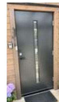
Ytterdør. Dørbladet har en liten skade på overflaten
