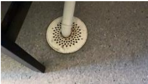
Plastsluk i gulv.
