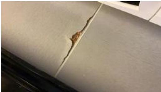
Svelleskade på benkeplate.
