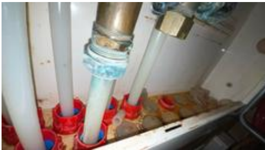
Irr på koplinger i fordelerskap og merker etter rustvann i skapet.
