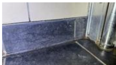
Eksempelbilde av misfarget fugemasse.
