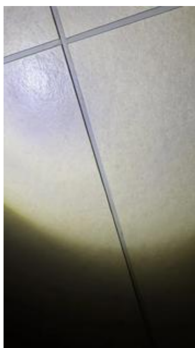
Eksempelbilde av glippe i skjøt til våtromsplater.
