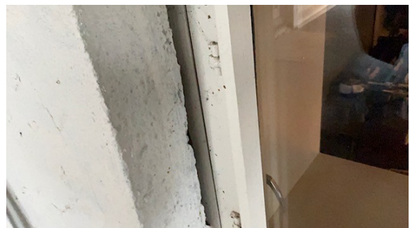
Manglende tetting rundt kjellervinduer.
