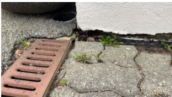
Utvasking under grunnmur.
