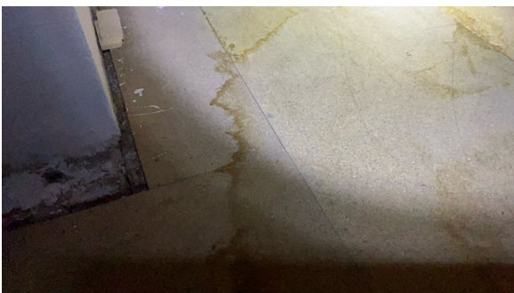
Fuktskjolder på gulv.
