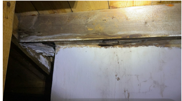
Fuktskjolder ved pipe.
