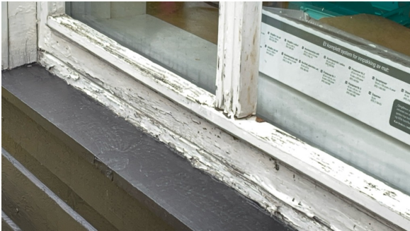
Slitasje på vindu.
