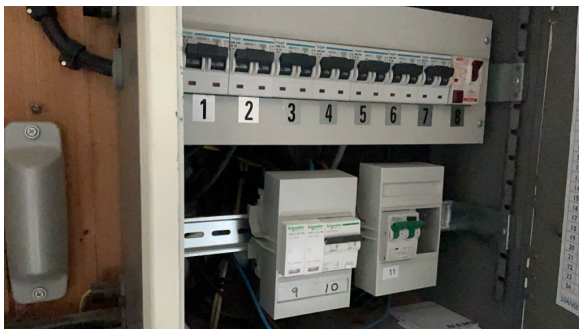
Sikringskap med automatsikringer.
