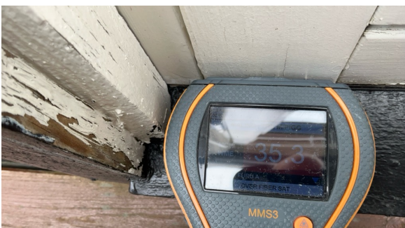
Terrassedør med forhøyet fuktnivå.
