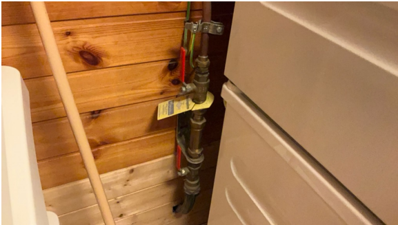
Stoppekran i vaskerom.
