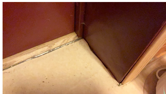
Manglende oppbrett ved dør
