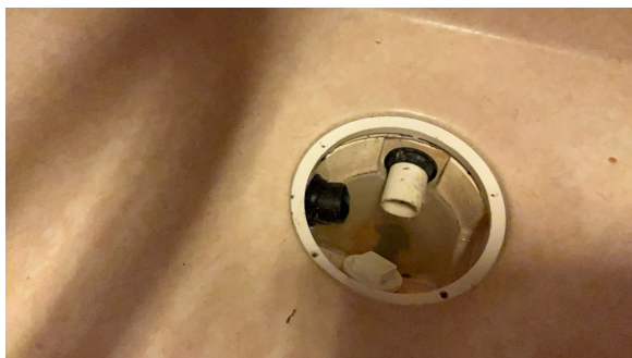
Sluk i vaskerom.
