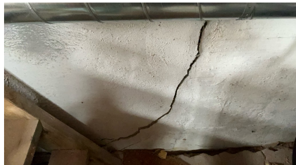
Skråriss i grunnmur.
