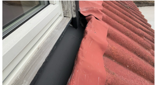
Beslag ikke korrekt montert.
