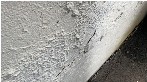
Murpuss som sprekker.
