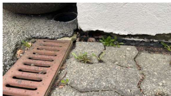
Utvasking under grunnmur.
