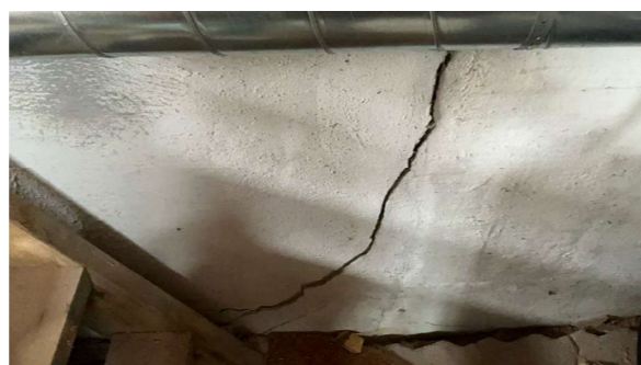
Skråriss i grunnmur.
