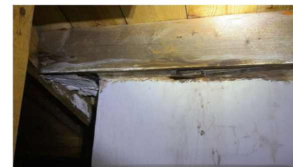
Fuktskjolder ved pipe.
