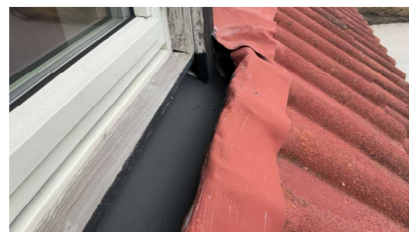
Beslag ikke korrekt montert.
