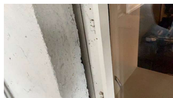
Manglende tetting rundt kjellervinduer.
