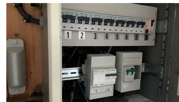
Sikringskap med automatsikringer.
