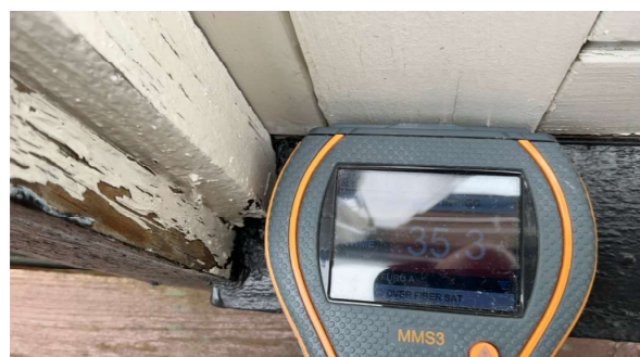
Terrassedør med forhøyet fuktnivå.
