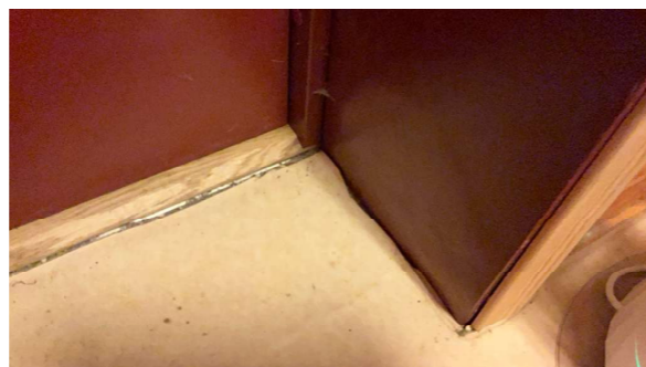
Manglende oppbrett ved dør
