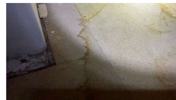
Fuktskjolder på gulv.
