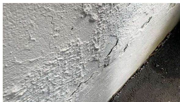
Murpuss som sprekker.
