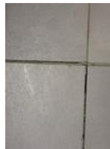
Løse fliser og fuger i baderomsgulv
