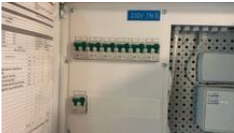
Sikringsskap med automatsikringer.
