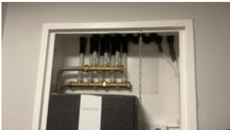
Vannskap med rør i rør.
