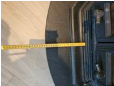
Ildfast plate mangler på gulvet under/foran ildstedet.
