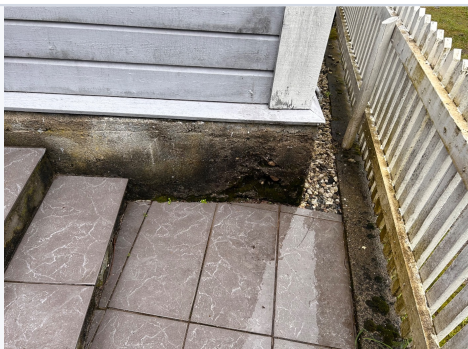
Skade på mur
