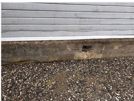
Sprekker i mur
