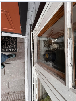
Spalte mellom vindauge og kledning/listverk.
