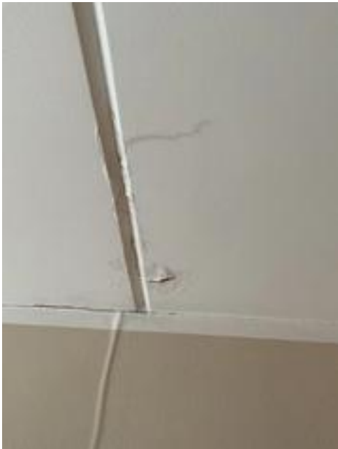
Fuktmerker og svelling / avflassing i himling.
