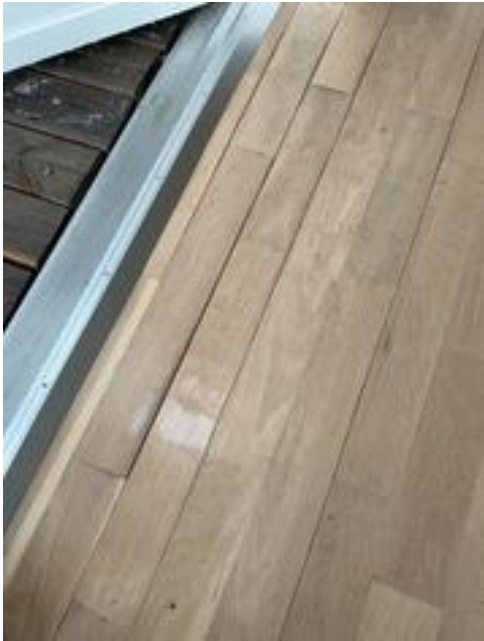
Fuktskade / gliper i parkett ved balkongdør.
