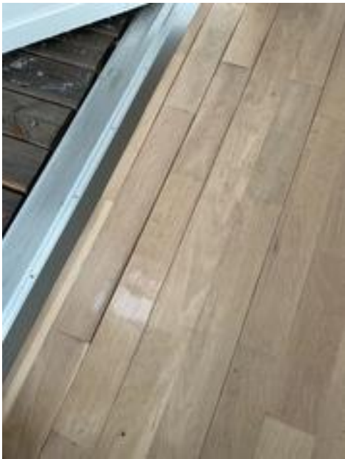
Fuktskade / gliper i parkett ved balkongdør.
