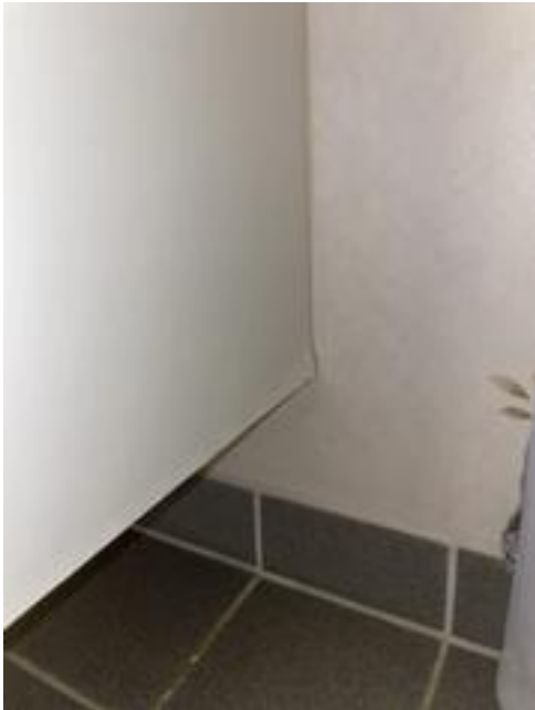
Svelling / skade i baderomsinnredning mot dusjsonen.
