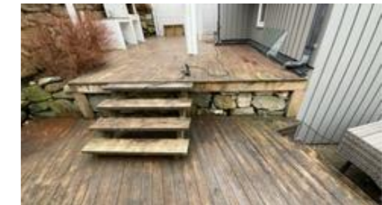
Høydeforskjell mellom terrasser er ikke sikret med rekkverk. Det er krav til rekkverk ved høydeforskjell over 50cm.
