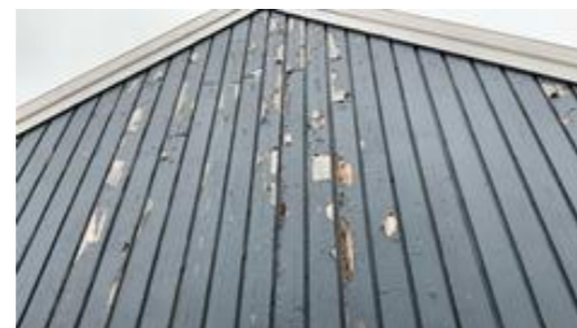
Råteskader i kledning på sørside.
