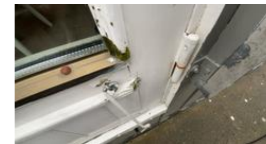
Nedbrytning og begynnende råte i utvendig treverk på terrassedør.
