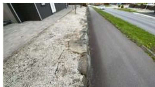
Støttemur på nedside av bolig er ikke sikret med rekkverk.
