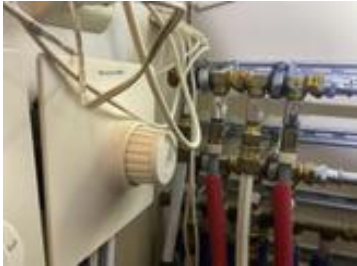
Rør i rør i teknisk nisje på vaskerom.
