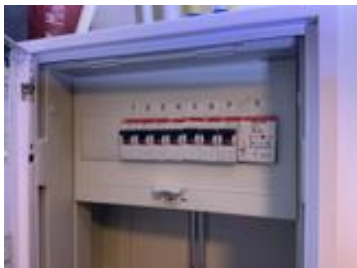
Sikringsskap med automatsikringer.
