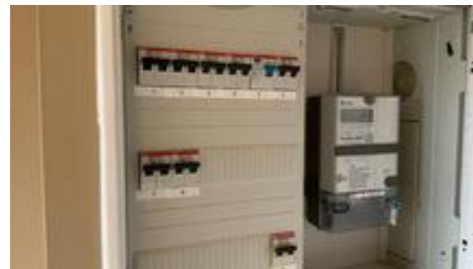
Sikringskap med automatsikringer.
