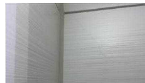
Sprekk i flis øverst i dusjsone
