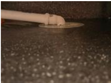
Sluk i gulv under dusjkabinett.
