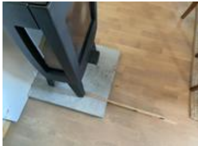
For liten avstand mellom ildsted og brennbart materiale/gulv foran.
