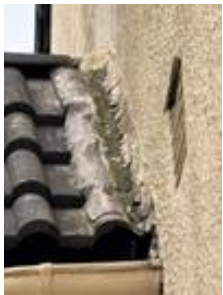
Sprikk/hull i blybeslag, her takoverbygg entre.
