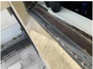
Malingsavflassing på de eldste vinduer.
