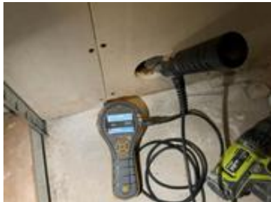
Fuktsøkt i påforet yttervegg i bod på side ved hovedtrapp ute.
