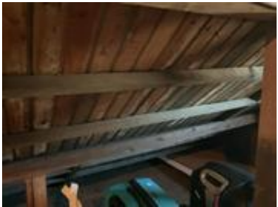
Merker i undertak etter kondensering.
