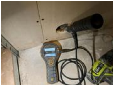
Fuktsøkt i påforet vegg i bod med for høye verdier.
