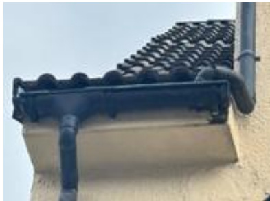
Lekkasjer fra takrenner, råteskader på stuebord under.
