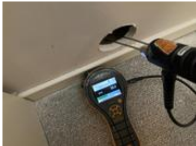
Fuktsøkt i påforet yttervegg hvor der er drenert i 2017.
