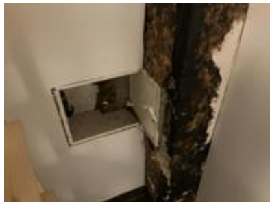
feieluke kommer nær brennbart materiale.
