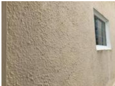
Sprikker og riss i fasader.
