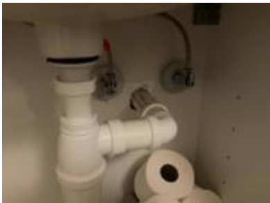
Ikke fuktett rørgjennomføring i vegg under vask.
