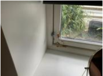
Skum på enkelte vinduer innside i kjeller.
