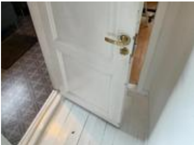
Bruksslitasjer på innerdører.
