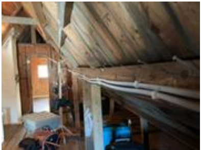
Nedsig av takkonstruksjon.
