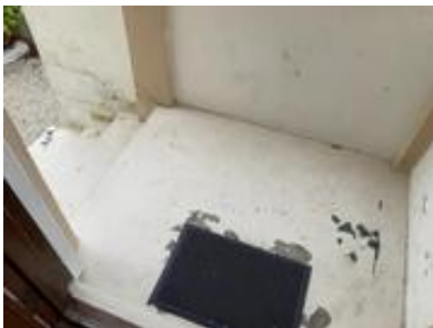
Sprekker, riss og avskallinger på hovedtrapp.
