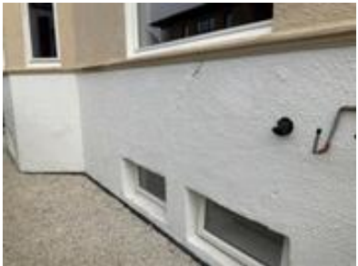
Avskallinger/riss på grunnmur.
