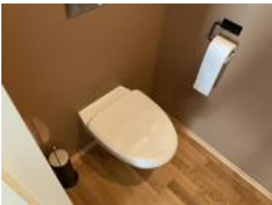
Toalett med skjult sisterne.
