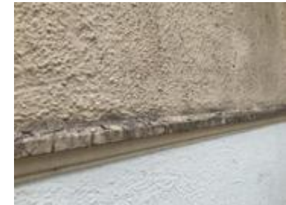
Avskallinger på fasader.
