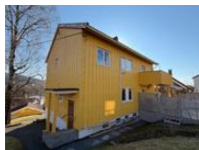
Fall mot grunnmur fra oversiden
