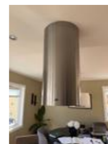
Fritthengende ventilator har begrenset funksjon/utsug
