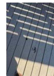
Råte i 2 terrassebord-mulig det kan være flere.
