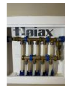
Rørskap på utsiden av baderomsvegg i entre/gang med 2 x stoppekraner
