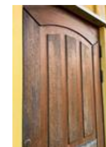
Svertesopp på utsiden av entredøren.
