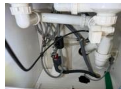
Rørpropp i kjøkkenbenk
