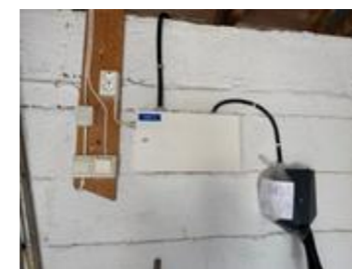
El.anlegg i garasje med elbillader.
