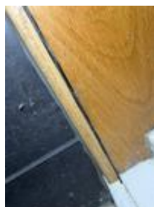
Banemembran er synlig ved vaskelist ved dør.
