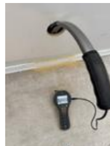
Hulltaking er foretatt med pigger i svill uten unormale utslag.
