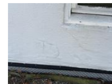
Løst puss stedvis på grunnmur.
