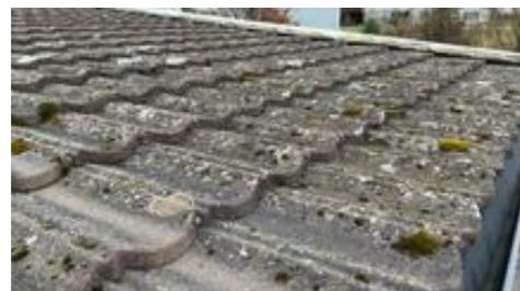
Slitasje og mose på tekking.
