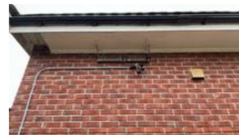
Utvendig kopling på vegg.
