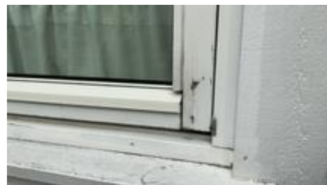
Slitasje på vindu.
