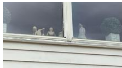
Slitasje på vinduer.
