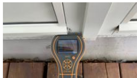
Terrassedør 1. etg. høyt fuktinnhold.
