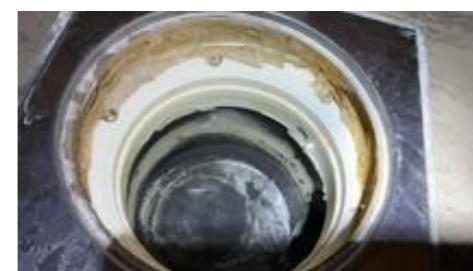
Ikke fagmessig plassering av membran.
