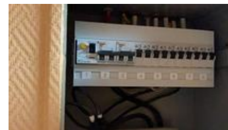
Sikringskap med automatsikringer.
