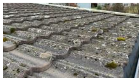
Slitasje og mose på tekking.
