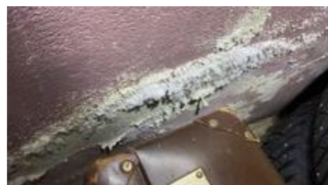
Saltutslag på vaskerom.
