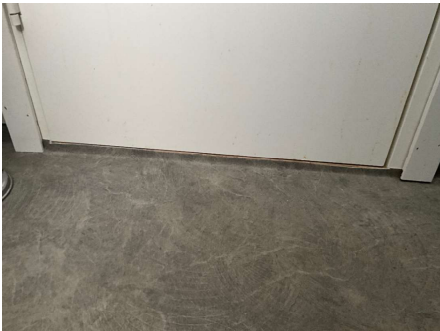
Bildet viser manglende luftespalte under dør.
