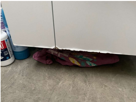
Bildet viser oppsvulmet skapdør.
