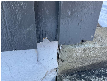
Bildet viser kledningsbord med spredt råte i nedre del.
