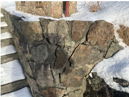
Bildet viser sprekker i støttemur av betong.
