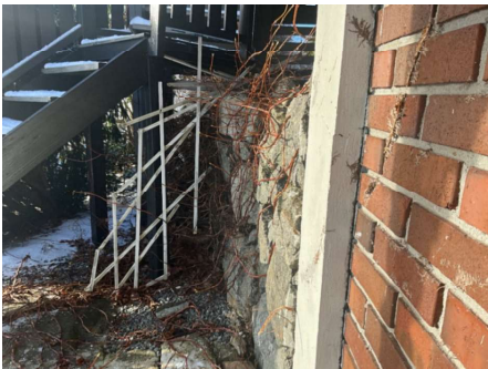
Bilder viser støttemur som heller utover.
