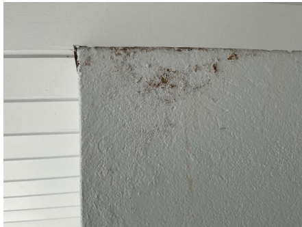
Bildet viser innvendig pipe med rennemerker.
