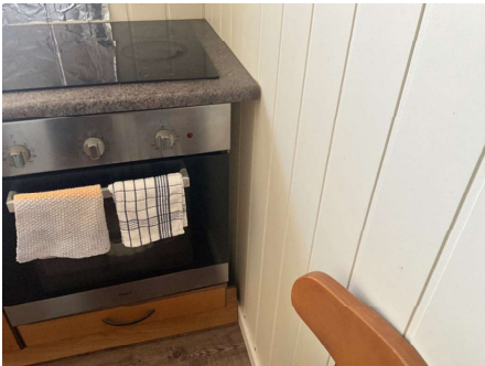
Bildet viser manglende dekklist mellom innredning og vegg.
