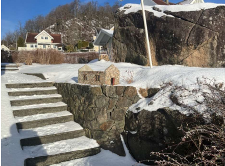
Bildet viser støttemur med manglende rekkverk.
