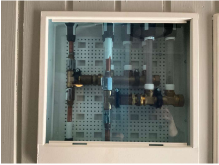
Oversiktsbilde av rørskap.
