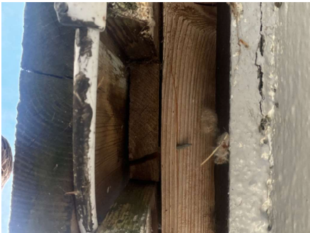
Bildet viser blokkert lufting av klednig.
