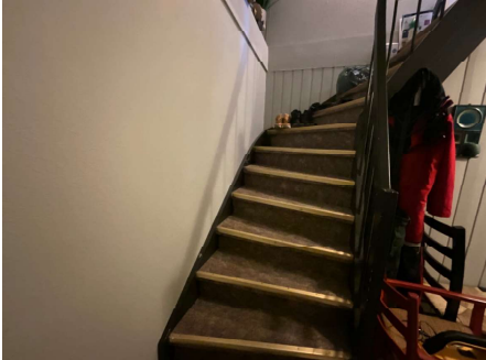
Bildet viser manglende håndløper på vegg.
