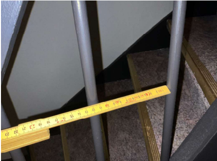
Bildet viser åpning i rekkverk til innvendig trapp som er målt til 11 cm
