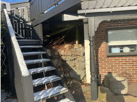
Bildet viser utvendig trapp med manglende rekkverk.
