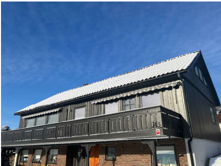
Bildet viser tak med manglende snøfanger.
