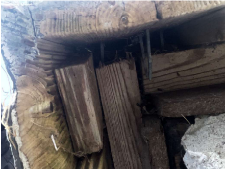
Bildet viser manglende musesperre.
