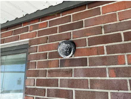
Bildet viser manglende ventilhette.
