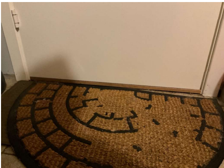
Bildet viser manglende luftespalte under dør.
