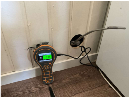
Fuktmålingen regnes som tørr og viser 10,9 vekt%
