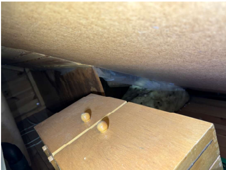
Bildet viser utettheter i dampsperre.
