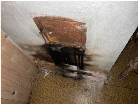
Bildet viser sotrenninger fra sotluken.
