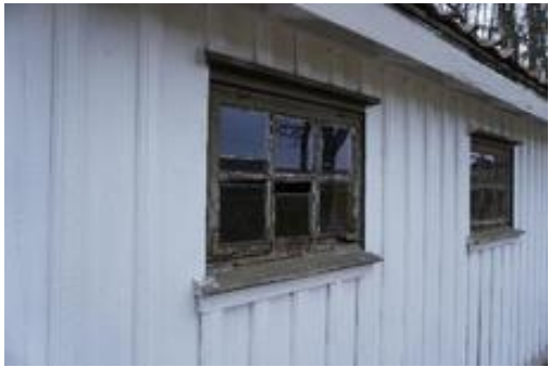
Foto 15: Uthus, vedlikeholdsbehov vinduer..
