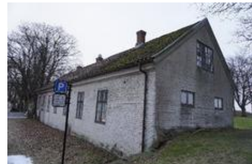
Foto 5: Vollmesterbolig med fuktinntrenging i vegg.
