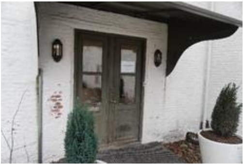
Foto 16: Ingeniørgården, dør med vedlikeholdsbehov.
