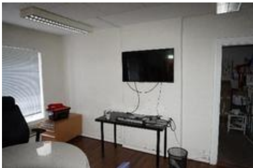
Foto 19: Vollmesterboligen, vegger med slitasje.
