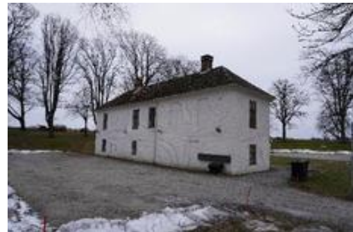
Foto 7: Ingeniørgården, enkelte sprekker og riss.
