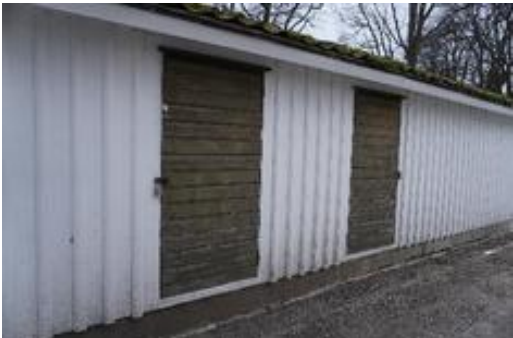
Foto 18: Uthus, dører med vedlikeholdsbehov.
