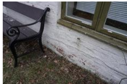
Foto 13: Ingeniørgården, vedlikeholdsbehov vinduer.
