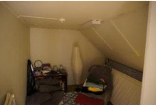
Foto 27: Vollmesterboligen: himlinger normal slitasje.
