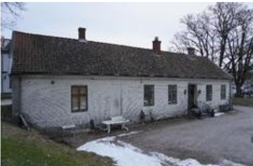
Foto 8: Vollmesterboligen, enkelte sprekker og riss.
