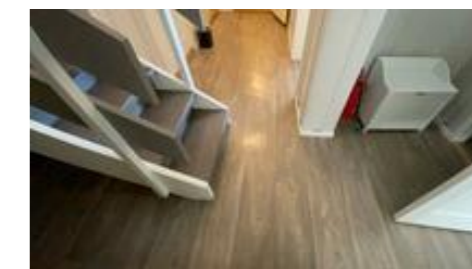
Gulvene har ujevnheter.
