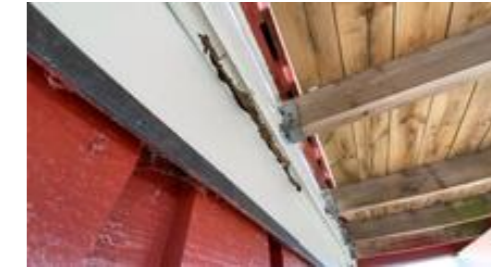
Forhudningspapp er stedvis oppsprukket med eksponert isolasjon.
