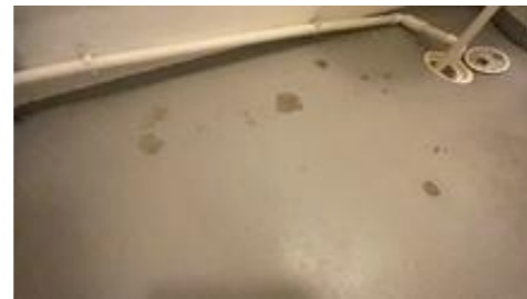
Malingsavflassing på gulv.
