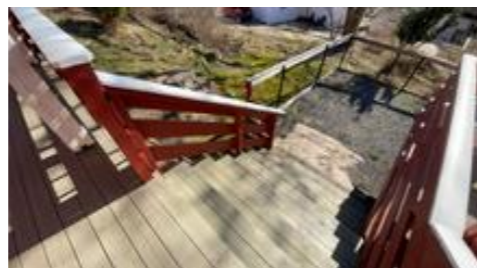
For lavt rekkverk
