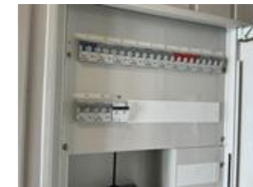
Sikringsskap med automatsikringer.
