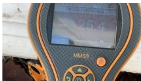
Forhøyet fuktnivå i kledning.
