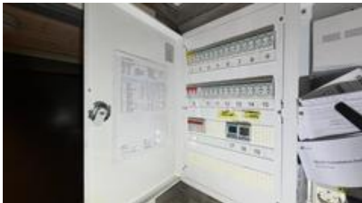
Bildet viser sikringsskapet for det elektriske anlegget.
