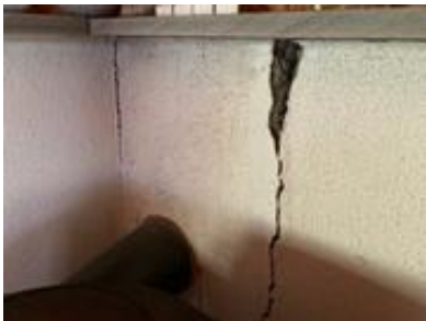
Sprekker i brannmur
