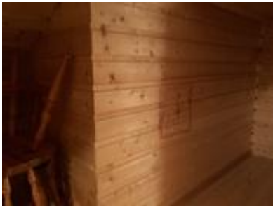
Pipe innkledd på loft
