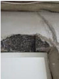
Det er registrert skade over dør til hybel i kjeller.
