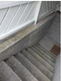
Det er registrert små riss og sprekker i puss/grunnmuren.
