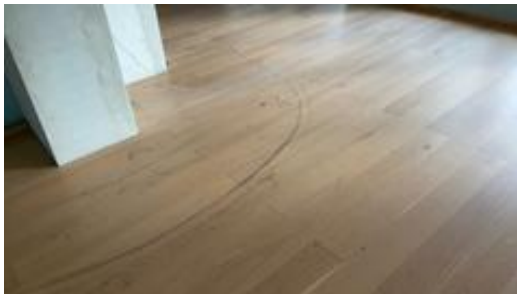
Større skrape i gulv stue/kjøkken
