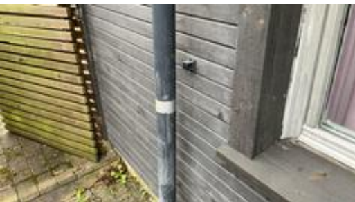
Nedløpsrør ikke festet til vegg.
