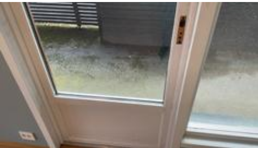
Mangler sylinder/håndtak balkongdør.
