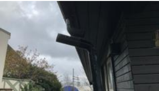
Ikke sammenkoplet avløp til nedløpsrør.
