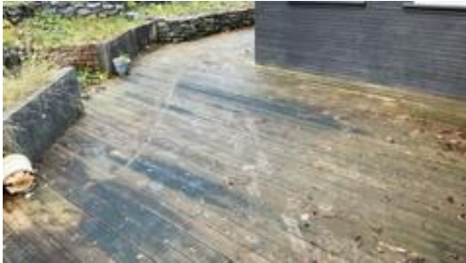
Værslitte/merker på terrassebord terrasse.
