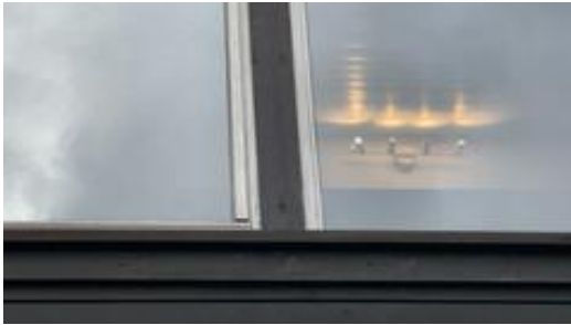
Oppsprikking/værslitte overflater på vinduer.
