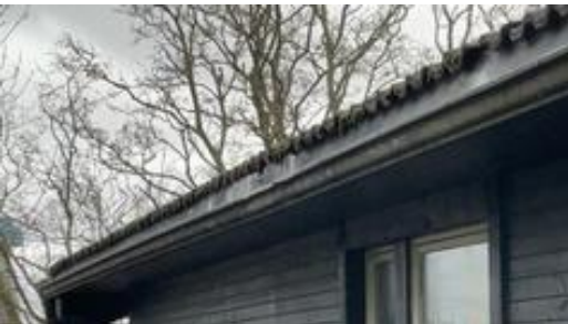
Bunk/skade i takrenne.
