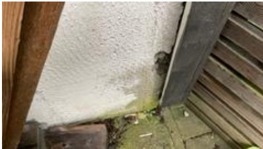
Avskalling/avflassing på mur.
