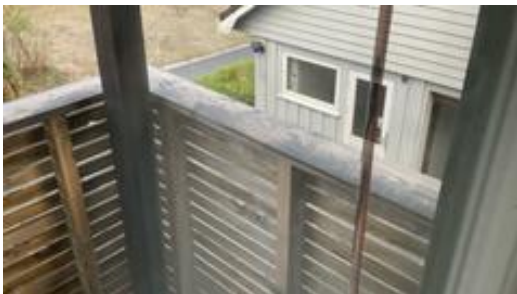
Værslitte overflater/rekke på balkong
