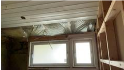
Mindre del av skråtakskonstruksjon ligger åpen-
