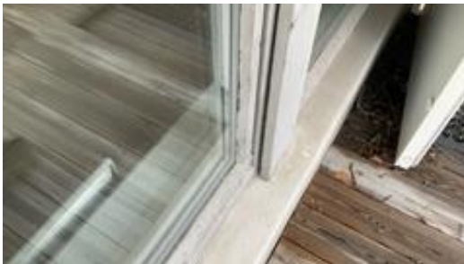
Belistning ikke klemt godt mot vinduskarm
