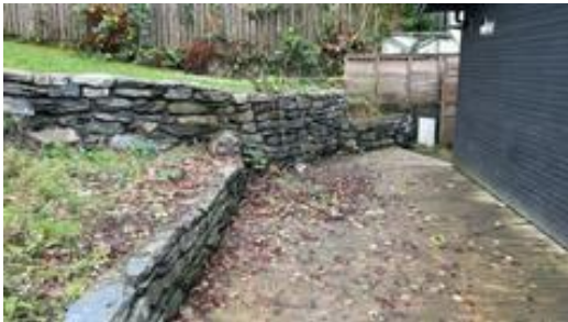
Forstøttningsmur uten fallsikring/rekkverk.
