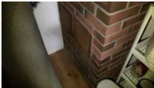
Pipe/feieluke i bod leilighet.
