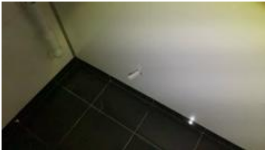
Drensåpning fra vannfordelerskap i leilighet.
