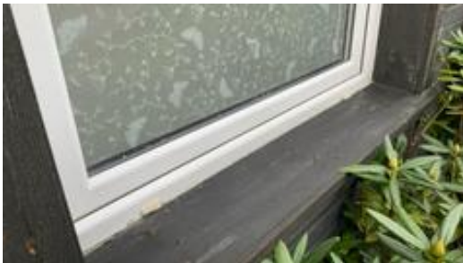
Ikke fagmessig montert skråbord under vindu i underetasje.
