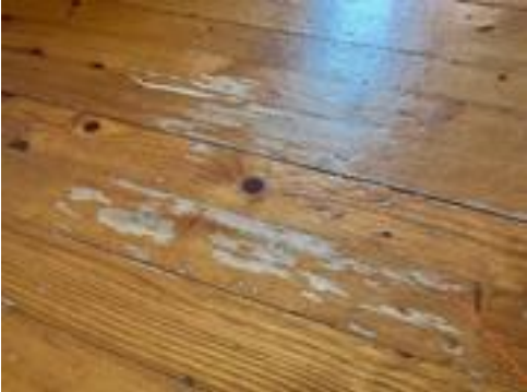
Eksempel på slitte overflater
