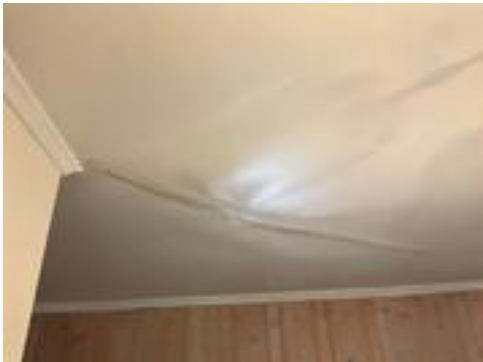
Duk i himling har revnet
