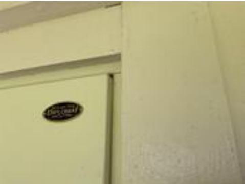
Ytterdør subber litt mot karm.
