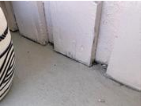
Værslitt kledning og stedvis ligger den ned mot plattning.
