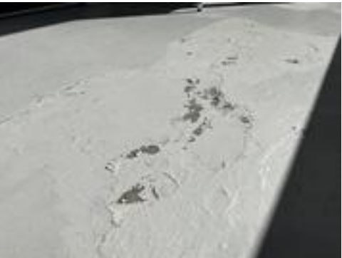
Slitasje på betongplate
