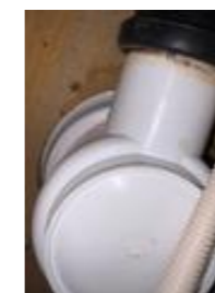
Bildet viser fuktskjolder i undergulv rundt sluk.
