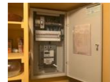
Oversiktspåse av sikringskapet.
