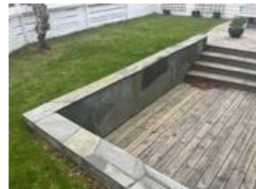
Bildet viser manglende rekkverk for mur ved terrasse.
