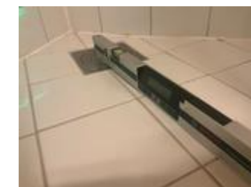
Bildet viser fallforholdet på gulv i dusj som er målt til 7 mm/m.
