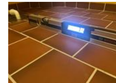
Bildet viser fallforholdet på gulv som er målt til 7 mm/m.
