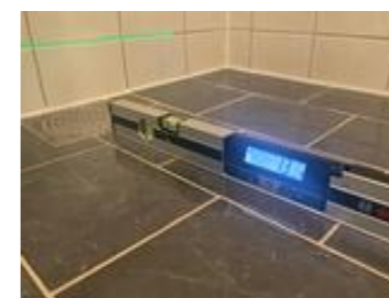
Bildet viser fallforholdet på gulv i dusj som er målt til 13 mm/m.
