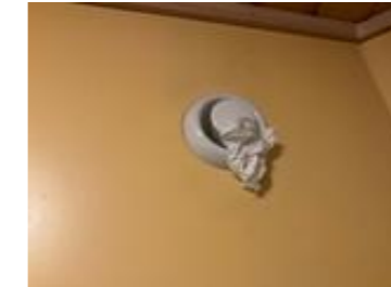
Bildet viser funksjonstest av avtrekk.
