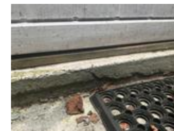
Bildet viser manglende beslag under dør.
