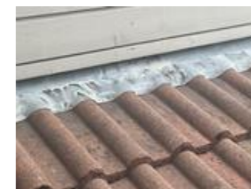
Bildet viser blybeslag med sprekker.
