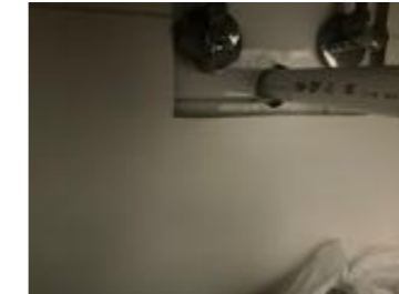
Bildet viser manglende tetting rundt rørgjennomføring under vask.
