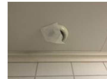
Bildet viser funksjonstest av avtrekk.
