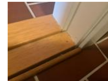
Bildet viser manglende membranoppbrett ved dørterskel.
