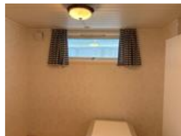
Bildet viser vindu som ikke er godkjent som rømningsvei.
