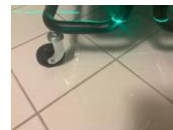
Bildet viser sprukne fliser.
