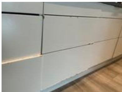
Fuktskade på skuffefronter
