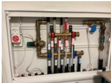
Fordelingsskap for tappevann
