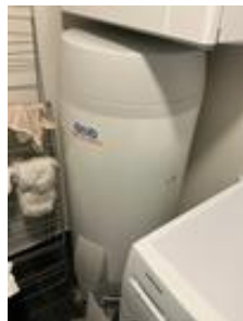
Varmtvannstank på vaskerommet
