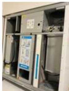
Balansert ventilasjon med varmegjenvinner
