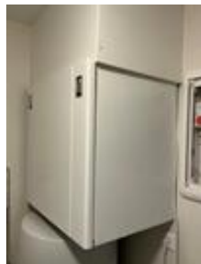
Balansert ventilasjon med varmegjenvinner
