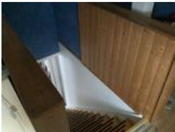
Begge rekkverk er løse.
