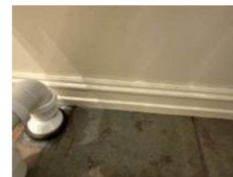
Gulvlister langs gulvet er ikke en godkjent løsning.
