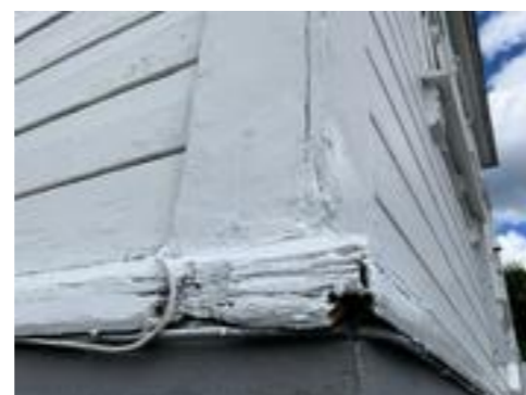
Råteskade og bruk av fugemasse.
