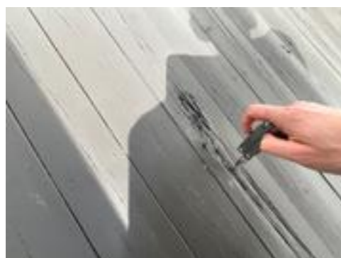
Råteskade i terrassebord på veranda mot nord.
