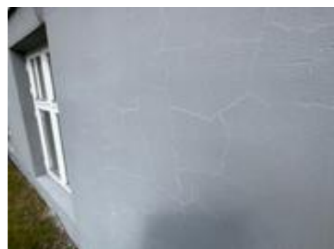
Krakelering i maling/ puss. FAGERVOLLVEGEN 11
