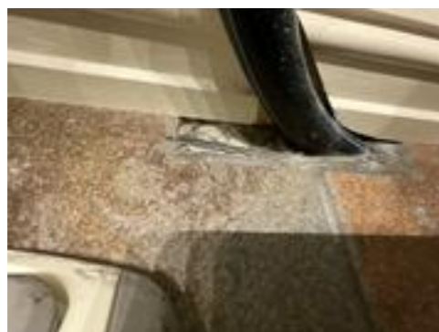
Gjennomføringen i gulv fremstår som utett.
