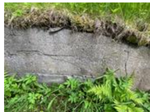
Sprekk i støttemur.
