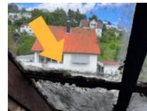
Sprekk i vindu og vindu fremstår som svært slitt. Dette vinduet er felles med nabodel, i følge eier.
