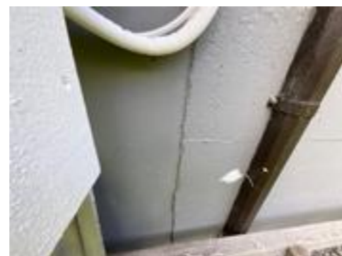
Sprekk i grunnmur.
