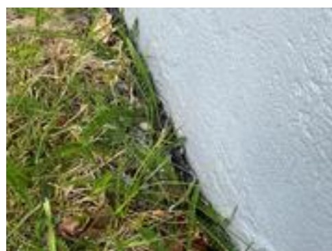
Knotteplast mangler overgangs list mot grunnmur.
