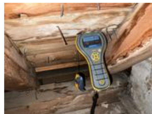
Fuktskjolder i taktro. Det er ikke målt unormale fuktverdier.
