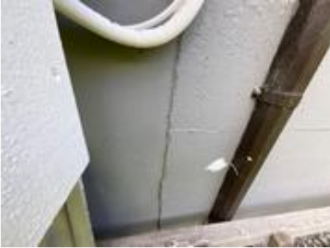
Sprekk i grunnmur.
