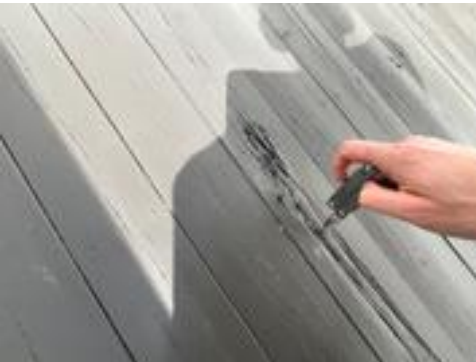
Råteskade i terrassebord på veranda mot nord.
