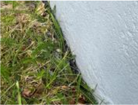
Knotteplast mangler overgangs list mot grunnmur.
