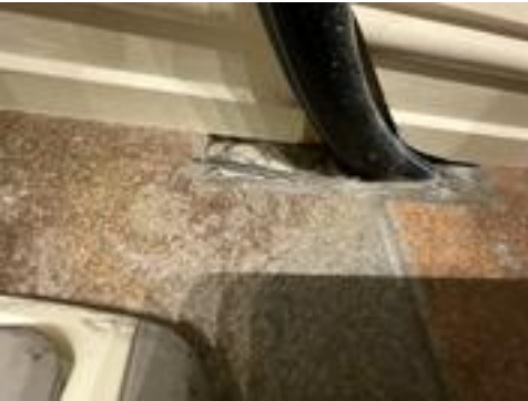
Gjennomføringen i gulv fremstår som utett.
