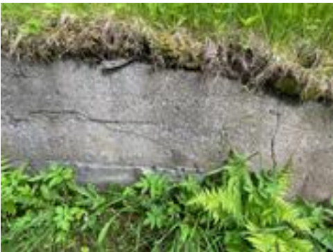
Sprekk i støttemur.
