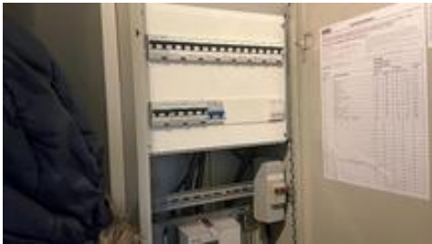
Sikringsskap med automatsikringer i 1. etasje
