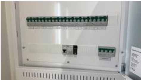
Sikringsskap med automatsikringer i kjeller.
