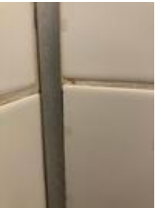
Glippe i mellom flis og hjørnelist i dusjsone
