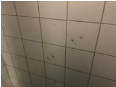
Skruehull i vegger i dusj.
