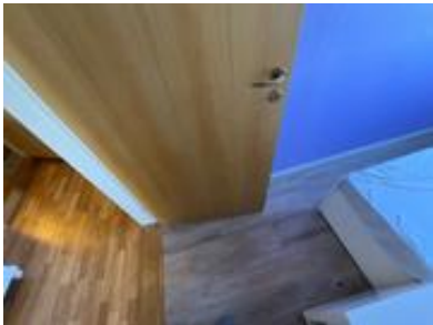
Dør til soverom subber i gulv
