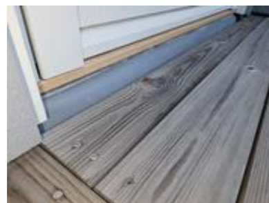
Det er ikke beslag under verandadøren i 2 etg
