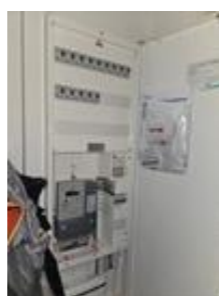
Sikringsskap med automatsikringer og kursfortegnelse
