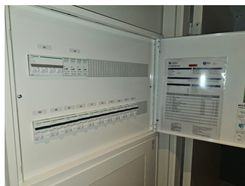
Sikringsskap med automatsikringer og kursfortegnelse
