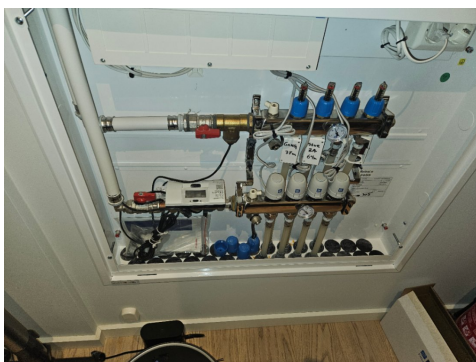
Fordelingsskap for gulvvarme
