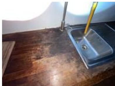
Skade på benkeplate.
