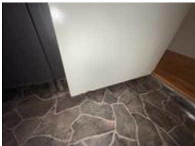
Fuktskade ned på dør til bad.
