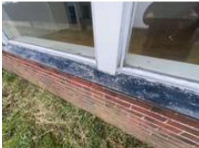
Nedre karm på store stuevindu er presset noe opp på midten.
