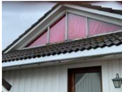
Enkelte vindu har råteskader
