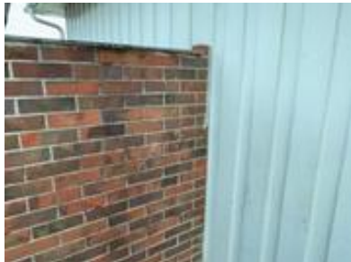
Teglforblending mellom bolig og garasje er avsluttet mot kledning.
