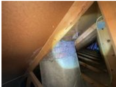
Det er påvist fuktskjolder i undertak ved pipegjennomføring.
