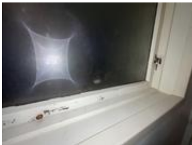
Tegn etter kondens i enkelte vindu.
