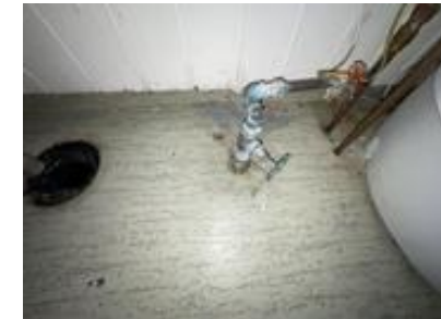
Drypplekkasje fra stoppekran.
