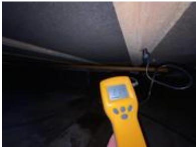
Det er målt noe høye fuktverdier ca. 21% i treverk under stubbegulv.
