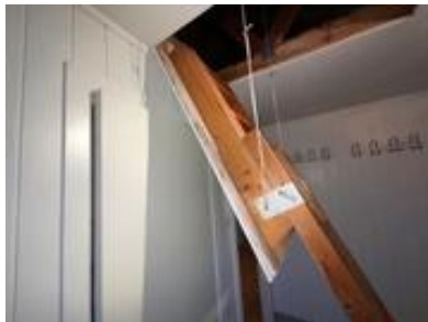
Loftluke er ikke isolert.
