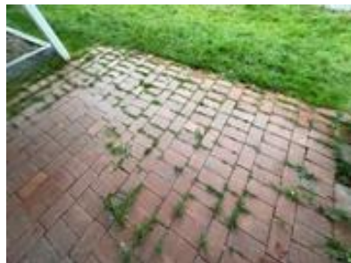
Flere defekte teglheller på terrasse.
