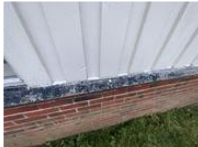
Liten avstand mellom kledning og teglforblending
