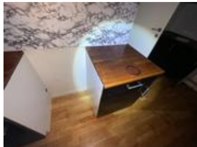
Skade på benkeplate.
