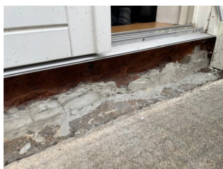
Manglende avslutning under skyvedør.
