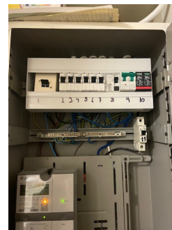
Sikringsskap med automatsikringer i utleiedel.
