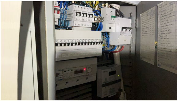
Sikringsskap med automatsikringer i hoveddel
