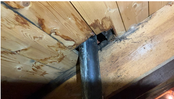
Fuktskjolder rundt gjennomføring.
