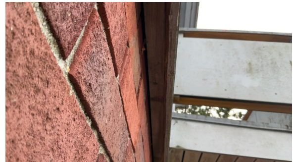
Manglende lufting bak kledning.
