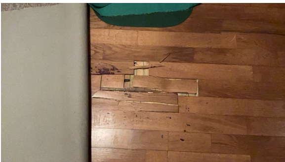
Skade etter vannskade.
