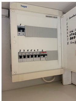
Sikringsskap med automatsikringer i hybel.
