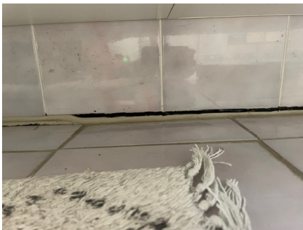
Sprekker mellom gulv og vegg.
