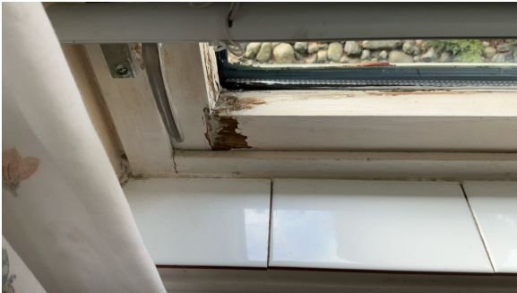
Slitasje på innvendige flater.
