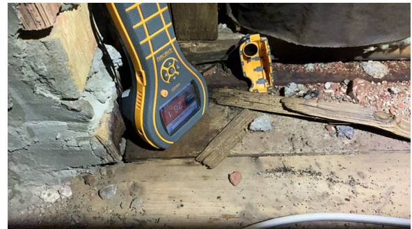
Høyt fuktinnhold ved pipe.
