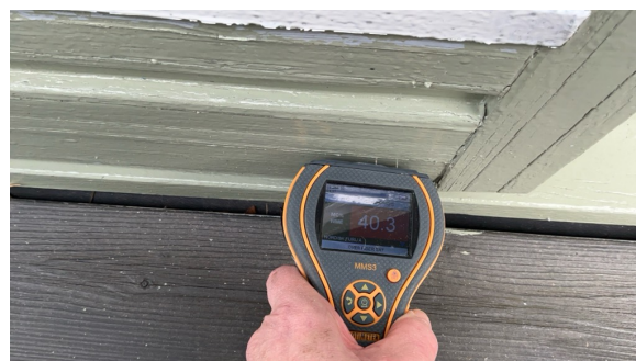
Forhøyet fuktnivå i skyvedør.
