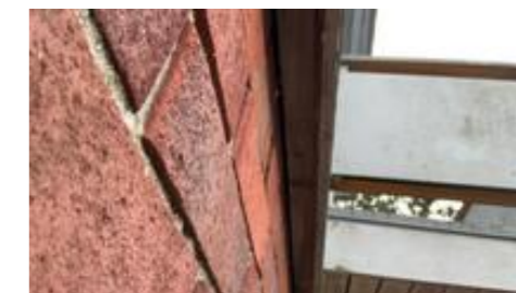
Manglende lufting bak kledning.
