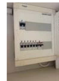
Sikringskap med automatsikringer i hybel.
