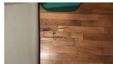
Skade etter vannskade.
