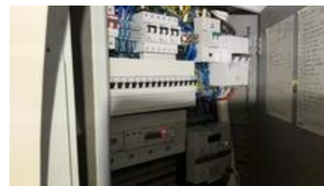
Sikringskap med automatsikringer i hoveddel
