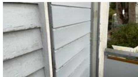
Enkel tett balkongdør.
