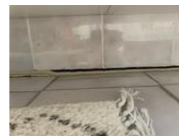
Sprekker mellom gulv og vegg.
