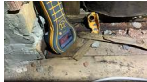
Høyt fuktinnhold ved pipe.
