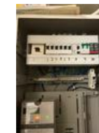
Sikringskap med automatsikringer i utleiedel.
