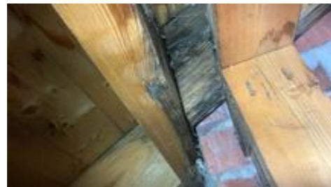
Råteskadet sperr ved pipe.
