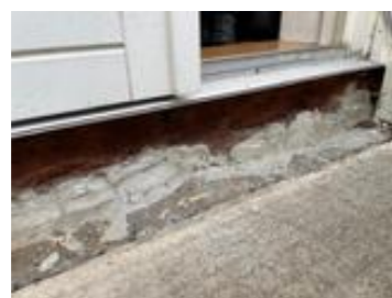
Manglende avslutning under skyvedør.
