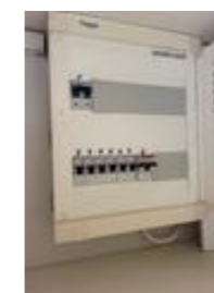
Sikringskap med automatsikringer i hybel.
