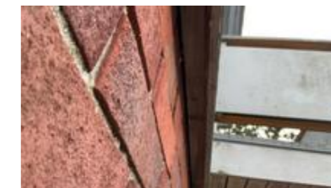
Manglende lufting bak kledning.
