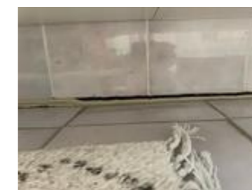
Sprekker mellom gulv og vegg.
