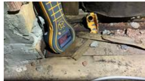
Høyt fuktinnhold ved pipe.
