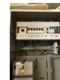
Sikringskap med automatsikringer i utleiedel.
