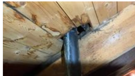
Fuktskjolder rundt gjennomføring.
