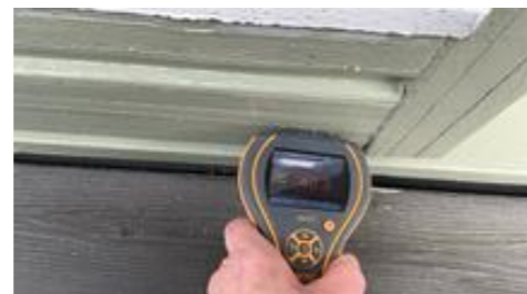
Forhøyet fuktnivå i skyvedør.
