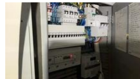
Sikringskap med automatsikringer i hoveddel
