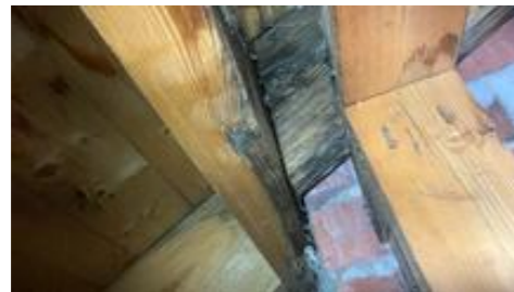
Råteskadet sperr ved pipe.
