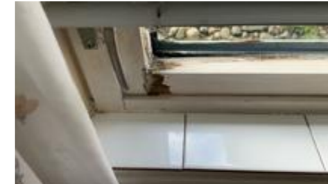
Slitasje på innvendige flater.
