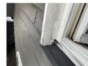
Råteskade i karm
