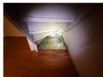
Symptomer på fuktgjennomtrengning under trappen.
