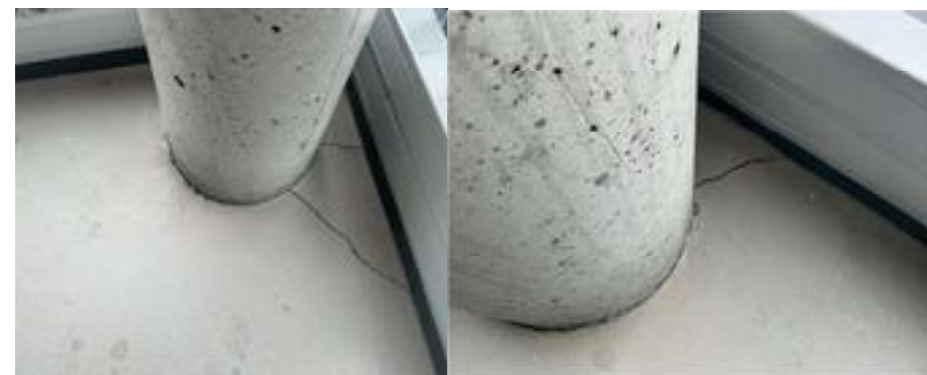
Riss/sprekker i betonggulv
