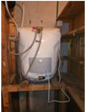
Varmtvannstank ca 120 liter i boden
