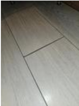
Glippe i tverrskjøten på laminatgulv
