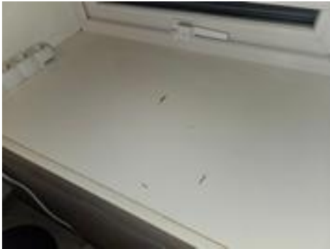
En del hakk og striper i malingen på innvendige utføringer rundt vinduer
