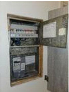
Sikringsskap med automatsikringer og kursfortegnelse
