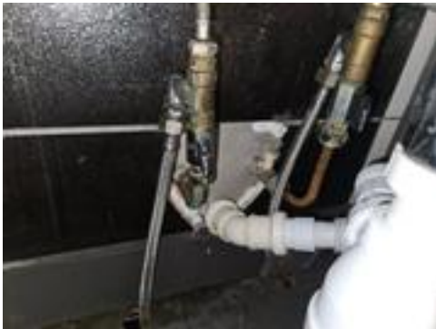
Ikke vanntette gjennomføringer for rør i veggen
