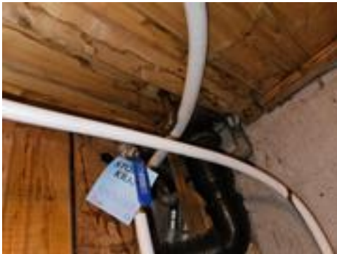
Stoppekran i den ene boden i 1 etg
