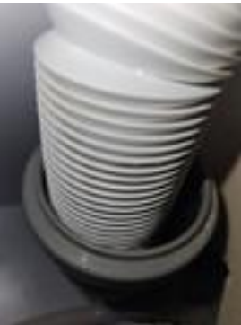
Avløp fra servanten på wc rommet er ført ned i et litt større avløpsrør, uten bruk av tettmuffe el. Overgangen er ikke tett
